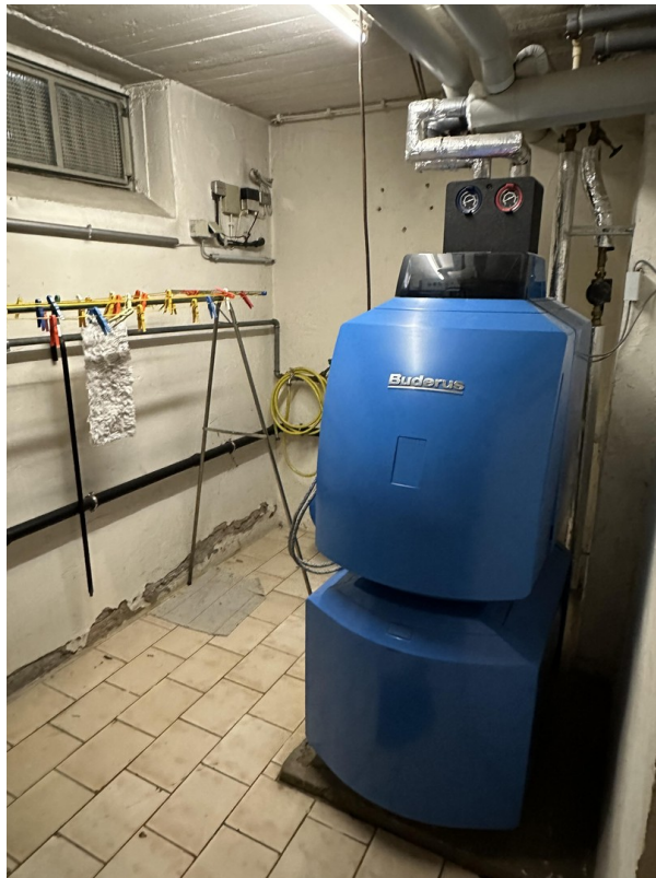
Haus 1 UG Heizung
