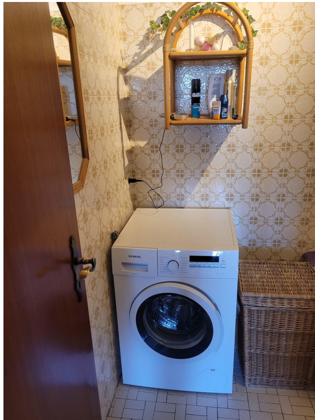
Waschmaschinenanschluss im Bad
