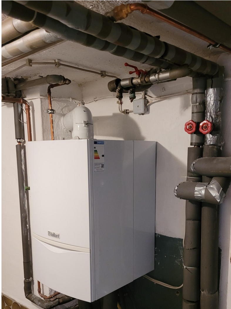
Gas-Brennwerttherme im Keller
