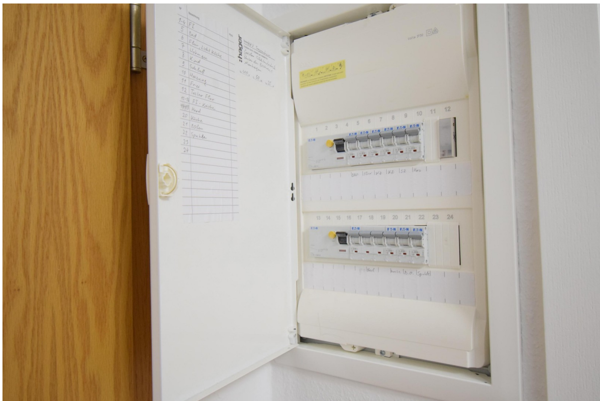
Elektrik mit Unterverteilung
