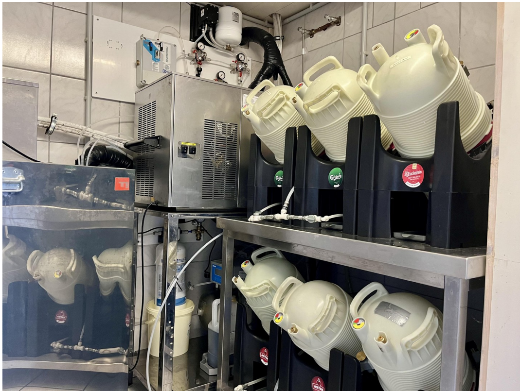
Bierpatronen im Lagerraum
