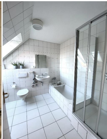
Gesamtansicht mit Wanne u Dusche
