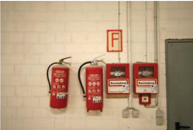
Feretlöschanlage Block III
