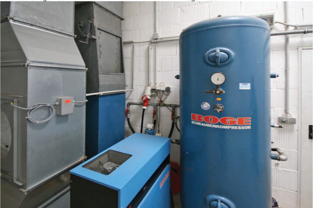
Druckluftanlage BLOCK III
