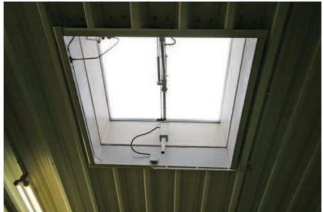
RWA-Anlage BLOCK III
